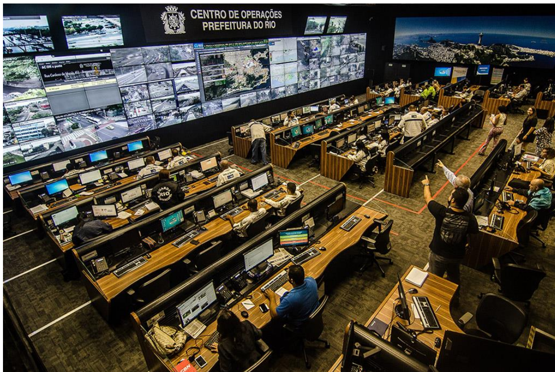
Figura 10. Sala de controle do Centro de Operações Rio – COR
